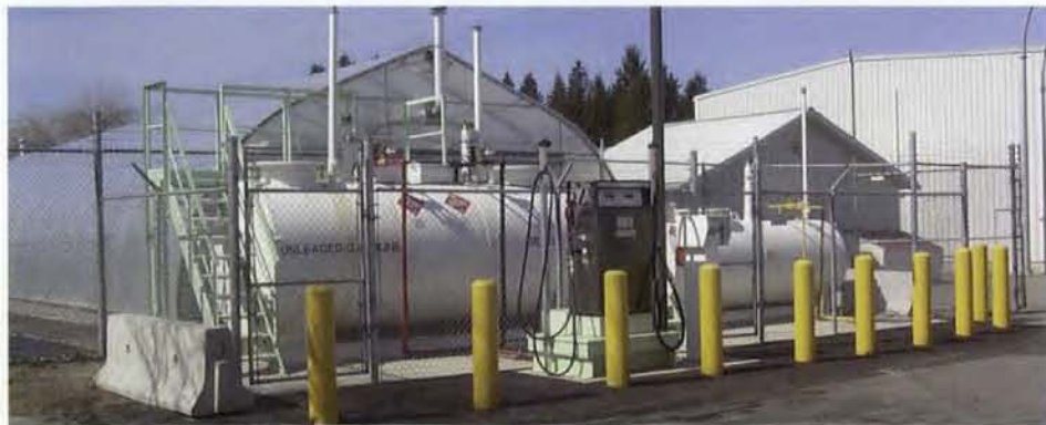
Réservoir d'essence avec système de récupération des COV - Phase 1 Établissement Ferndale
